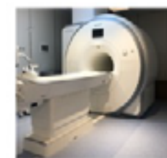
Nuova MRI (sostituzione)
